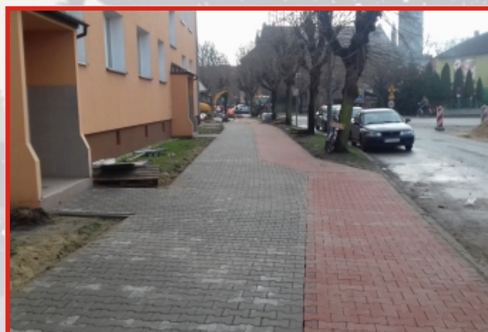
Budowa ciągu pieszo-rowerowego na ul. Chrobrego - I etap - 345.000,00 zł zakończenie inwestycji: grudzień 2017
